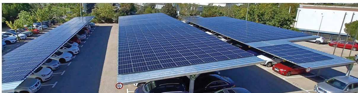
Instalación de sistema fotovoltaico con 187 kWp ubicados en la sede de Sportium y B2B situada en Sant Cugat (Barcelona)
